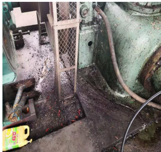
未及时清理渗漏到地面的油污
